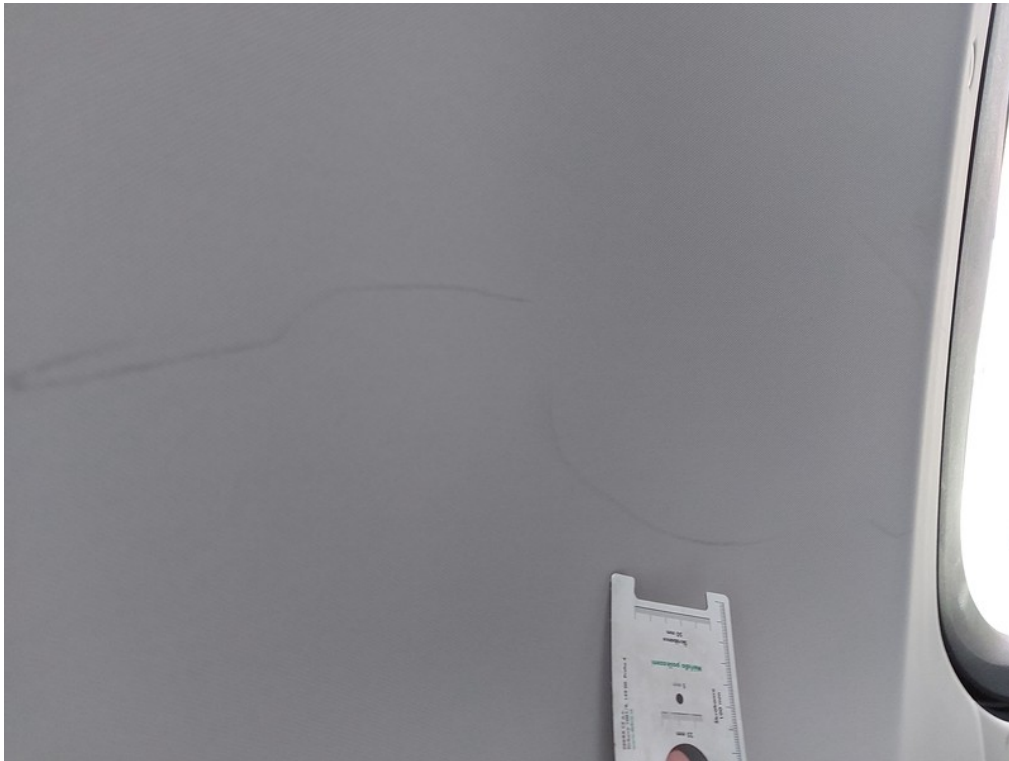
Viz popis k poškození č. 22
