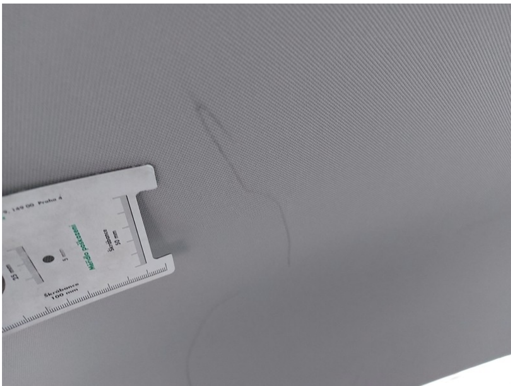
Viz popis k poškození č. 22
